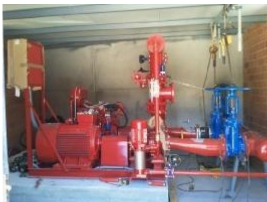
Red de defensa contra incendios
