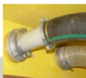
Bocas de carga y Venteo Y sus conexiones con vehículo de transporte.
