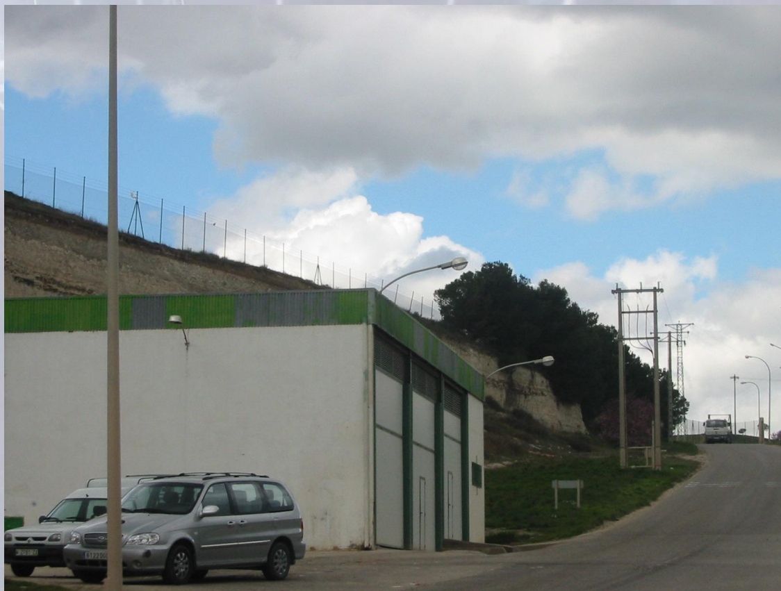
Punto de enganche a la red distribuidora de 13,2 KV
