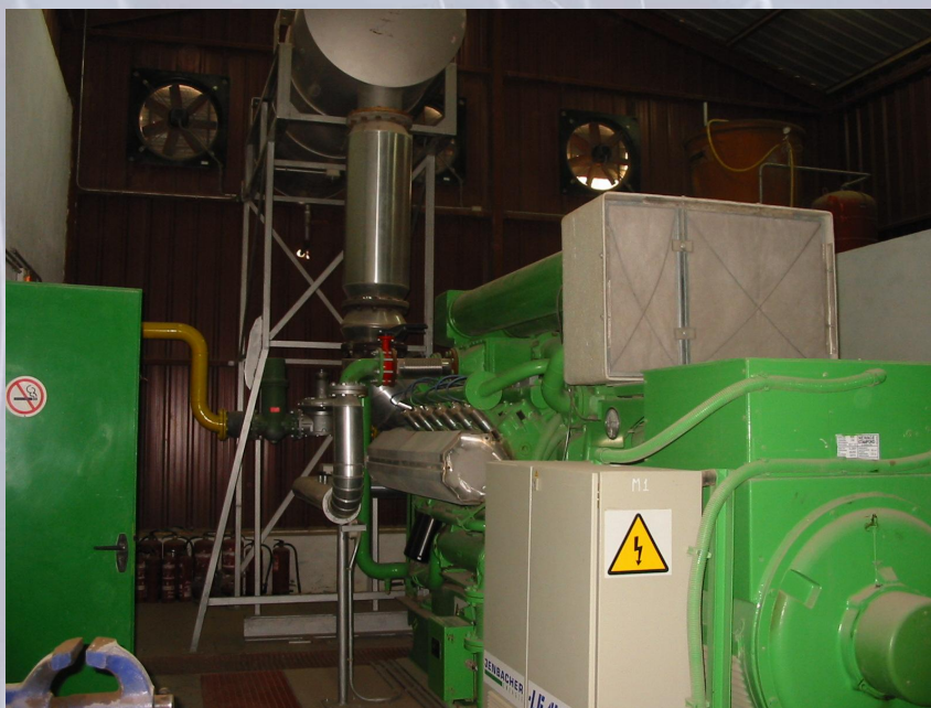
Sala Motor Genbacher 600 kW
