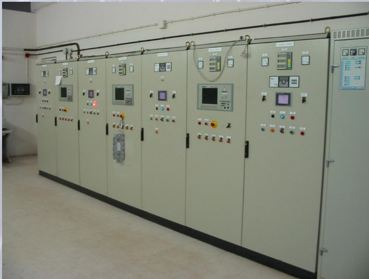
Centro de mando de motogeneración
