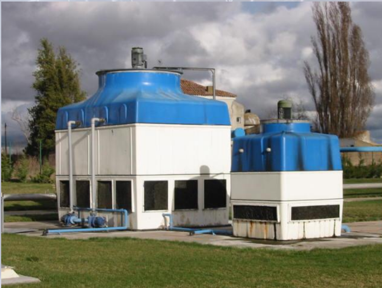
Torres de refrigeración de baja y alta temperatura
