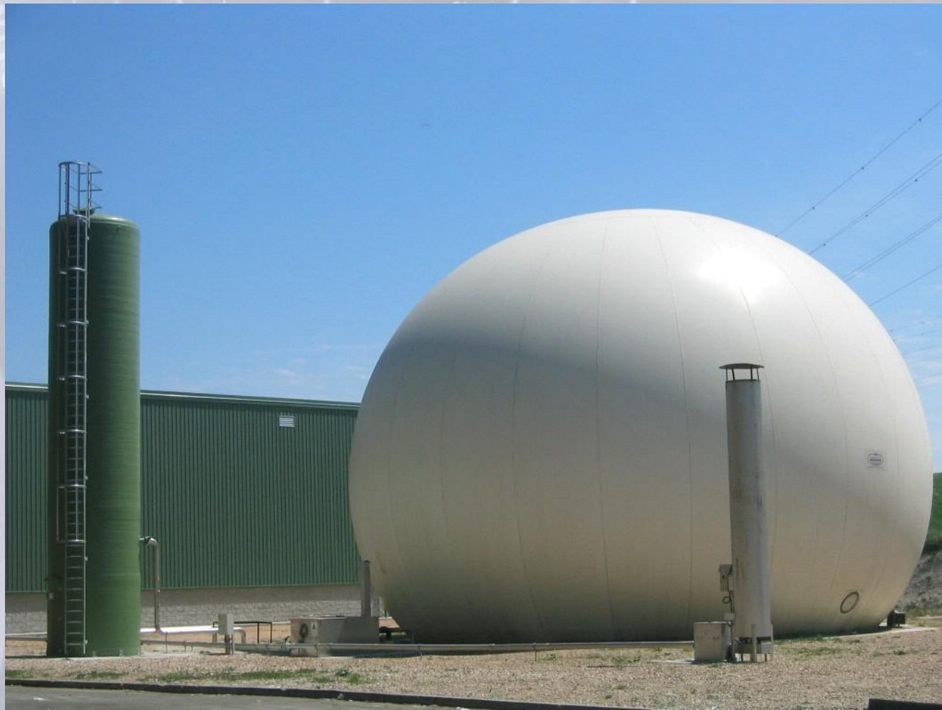
Gasómetro APRA, Desulfurizador biológico y Antorcha
